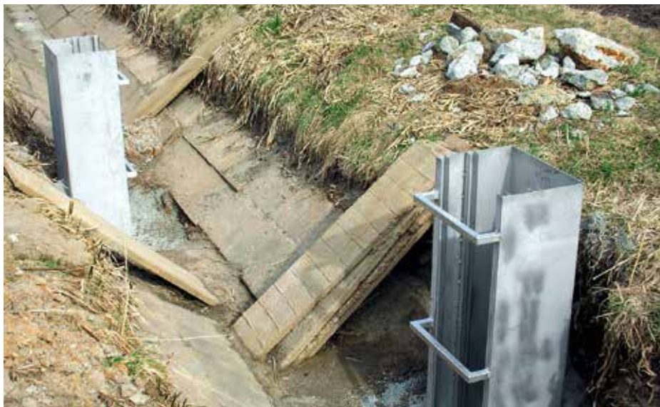
Einlassständer im Zulaufgraben in moderner Edelstahlausführung
